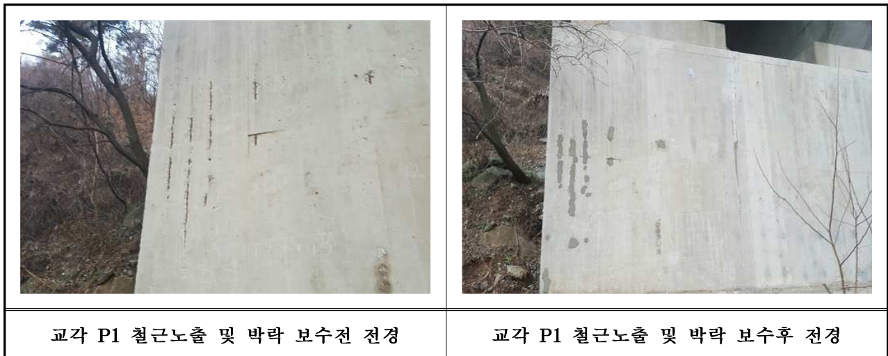
【사진 3.48】 백운1교(춘천) 교각 P1 철근노출 및 박락 보수 현황
