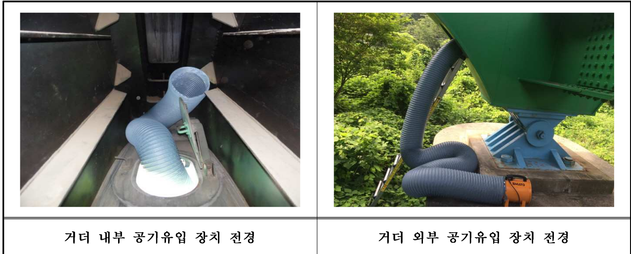
【사진 3.8】 백운1교(부산) 거더 내부 공기 유입 장치
